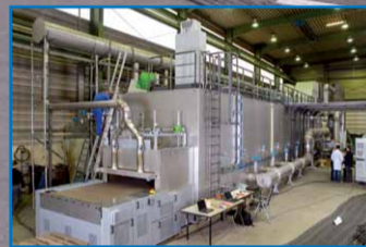
Gesamtansicht des Ofens im Warmlauf
