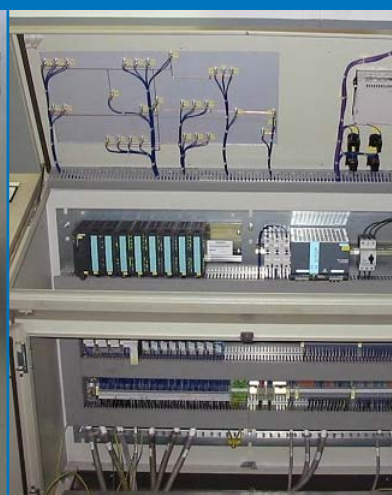
Blick in das Innere eines Schaltschranks
