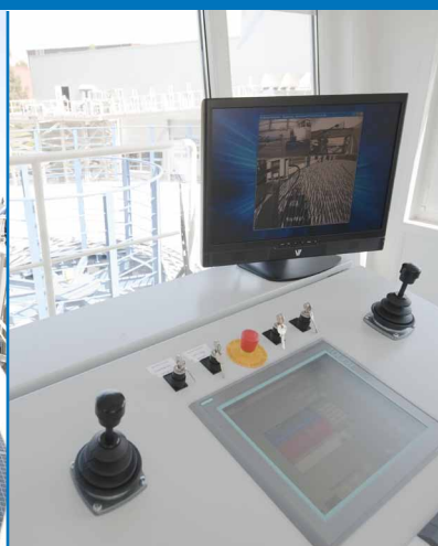
Blick in die Schaltwarte mit Bedienpanel und Joysticks zur Drehscheibensteuerung
